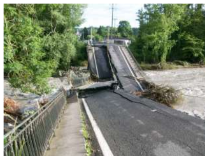
Le pont de Saint-Laurent-de-Neste détruit par la crue de juin 2013
